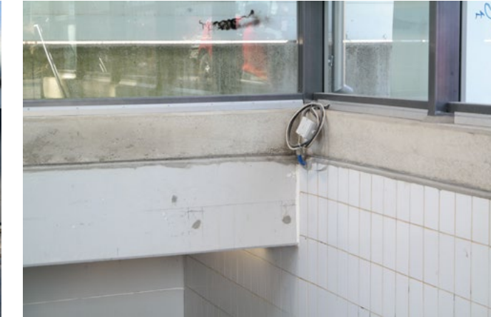
Vor mehr als einem Jahr wurde die Beleuchtung der neuen Einhausung des Treppenabgangs erneuert, die für alle Fahrgäste gut sichtbare Elektroinstallation sieht aber immer noch alles andere als professionell aus.
