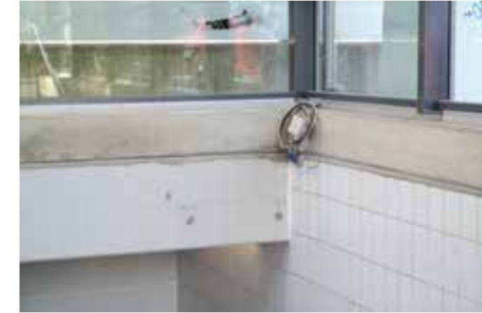
Vor mehr als einem Jahr wurde die Beleuchtung der neuen Einhausung des Treppenabgangs erneuert, die für alle Fahrgäste gut sichtbare Elektroinstallation sieht aber immer noch alles andere als professionell aus.
